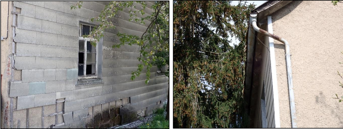
Abbildung 6: Einflugöffnungen in das Wohngebäude der Neufelser Straße 35 in Form von offenen Fenstern (linkes Bild) und Schäden am Dachtrauf als geeignete Fortpflanzungs- und Ruhestätten für gebäudebrütende Vögel und gebäudebewohnende Fledermäuse (rechtes Bild).
