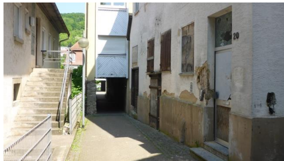
Foto 20: An der Stadtmauer - Sanierungsbedarf
