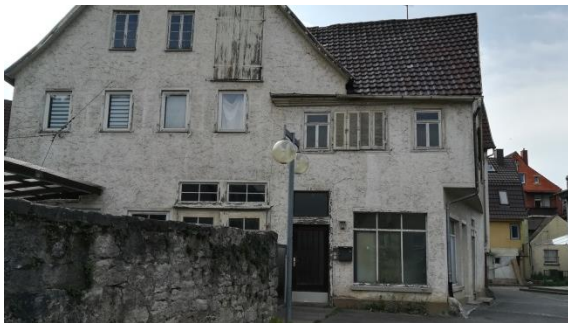
Foto 19: Gerbhausweg - sanierungsbedürftiges Gebäude
